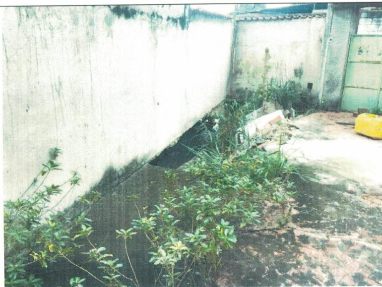
Figura 5 – Trecho do canal que sofreu colapso estrutural.
