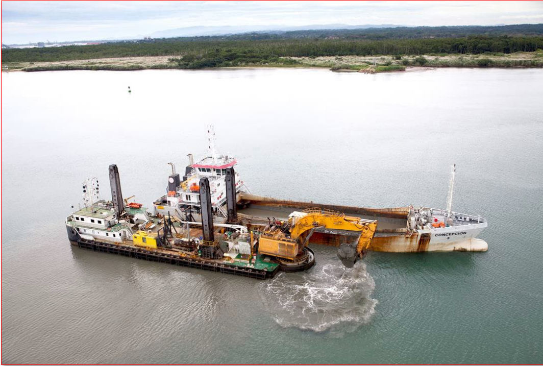
Figura 4-23: Sistema de fundeio de Backhoe por Spuds – permitindo o livre trafego ao redor da operação e livre atracação de batelões de carga.
