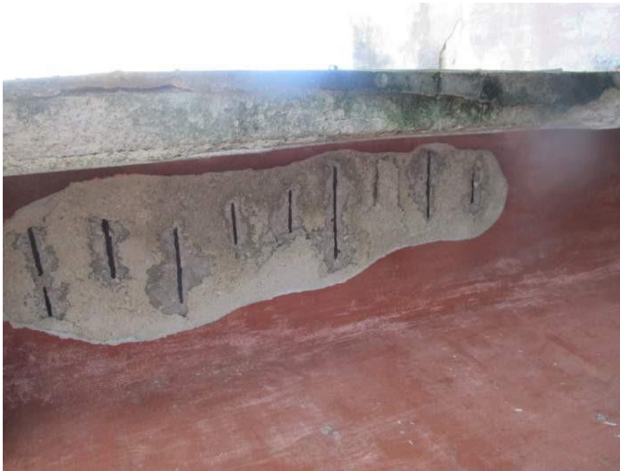
Foto 4 – Armadura exposta e oxidada em algumas estruturas do cinema.
