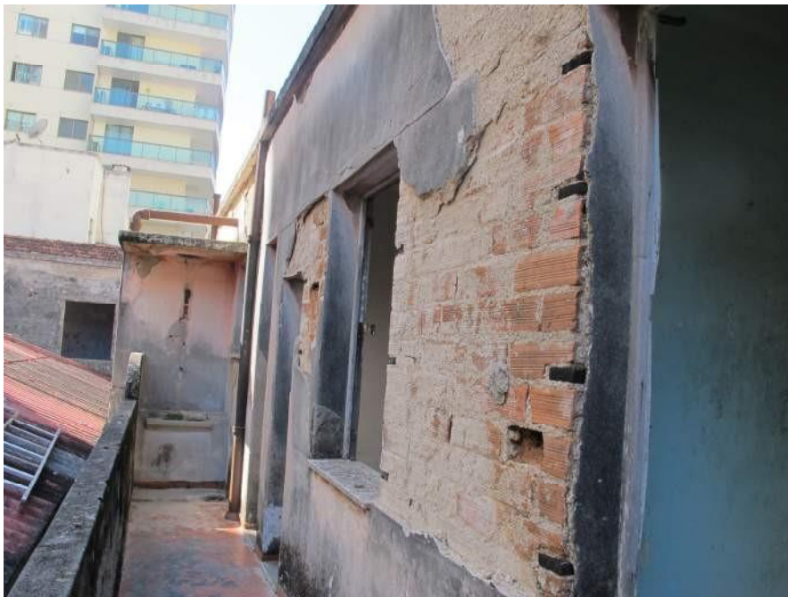
Foto 2 – Vista dos apartamentos localizados na cobertura.
