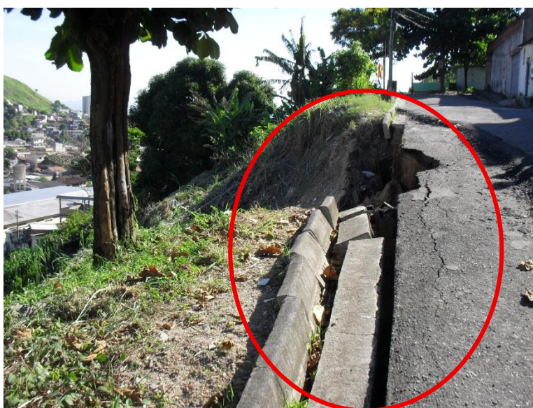
Figura 1 – Ponto 01: Trecho viário comprometido por movimentação do solo
