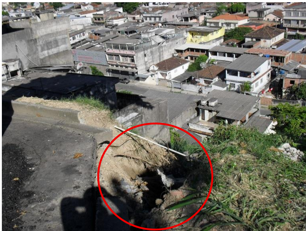
Figura 2 - Abertura no terreno ocasionada por escorregamento de encosta
