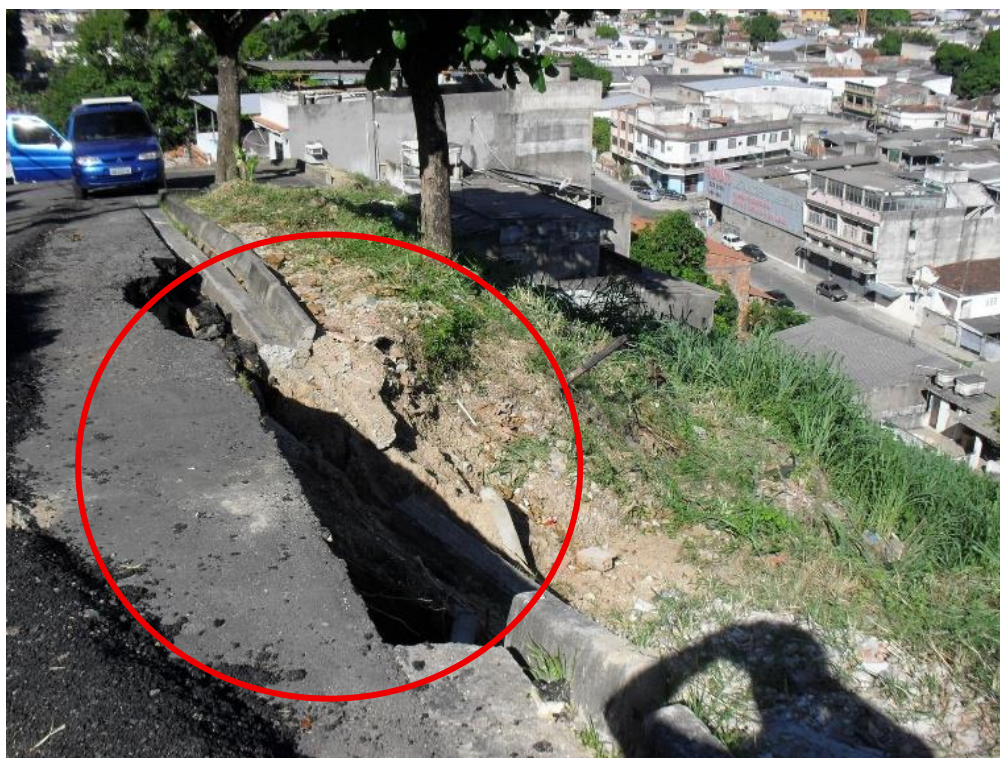
Figura 3 - Meio-fio e sarjeta comprometimento
