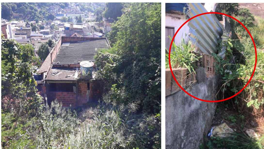
Figura 3 – Vista da casa atingida e lateral do muro da mesma danificado.
