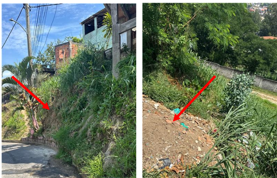
Figuras 1 e 2 – Talude com risco de deslizamento, o que pode comprometer a via de acesso.
