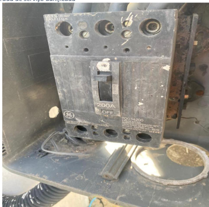
Figura 2 – Disjuntor com baixa capacidade
