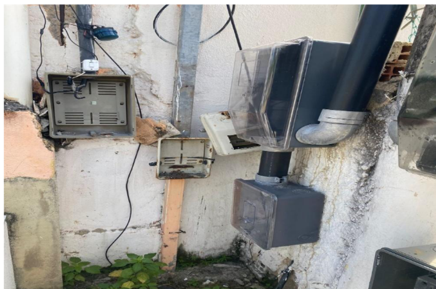
Figura 1 – Entrada de serviço danificada
