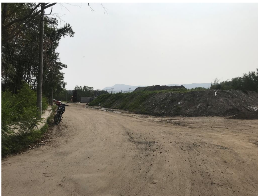
Figura 2 – Talude excedente na área da Pista Street do Skate Park.
