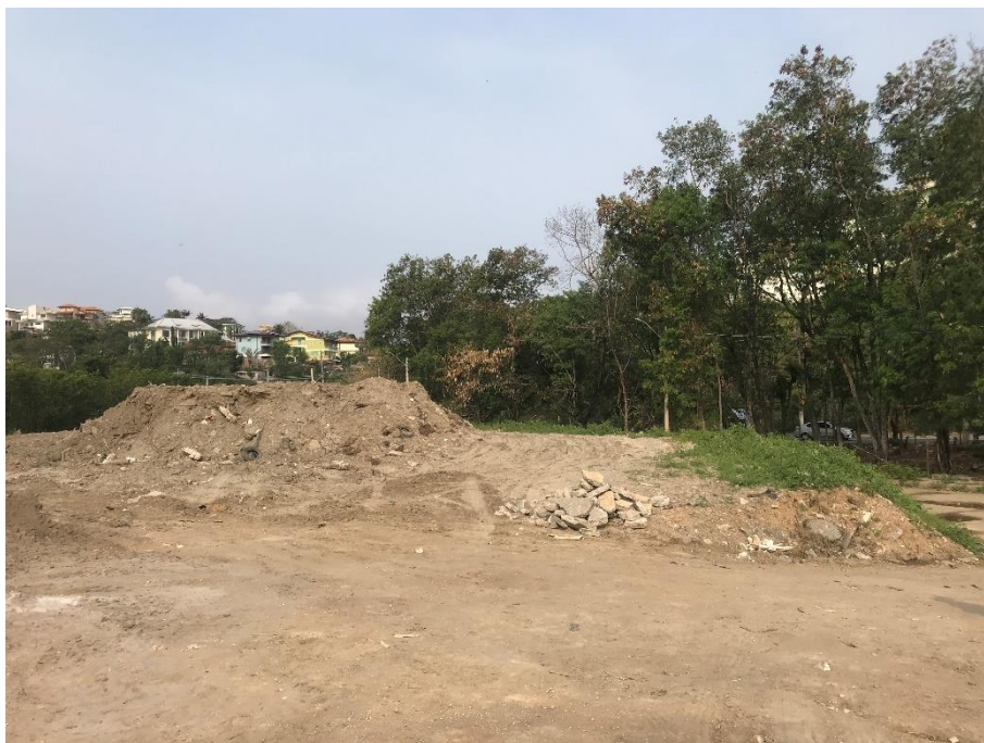
Figura 3 - Talude excedente na área do Bowl do Skate Park.
