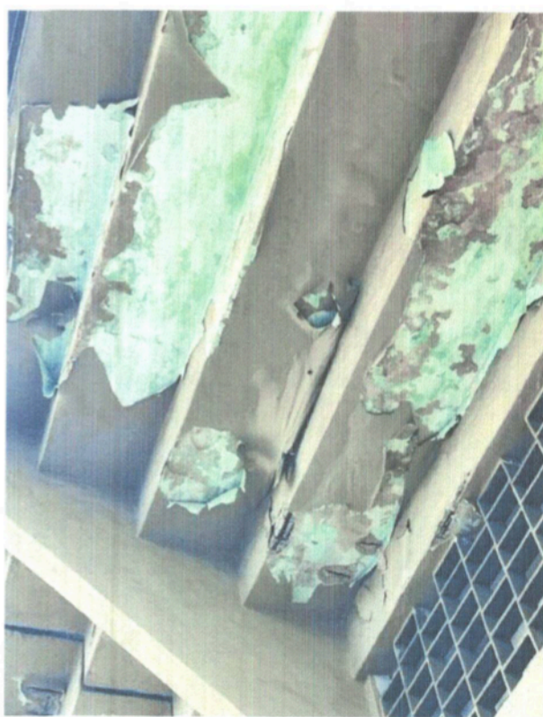
Figura 5: Deslocamentos de revestimento em pintura
