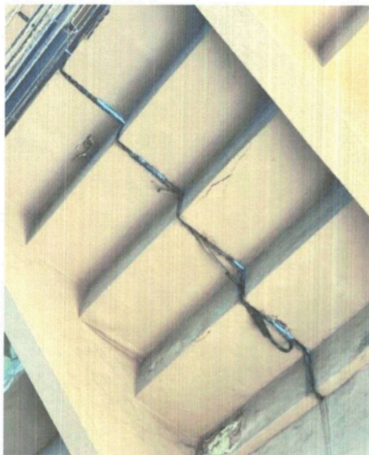
Figura 6: Junta de dilatação degradada
