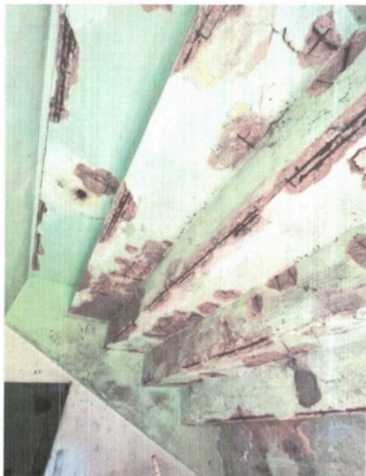
Figura 10: Corrosão severa em trecho do fundo da arquibancada
