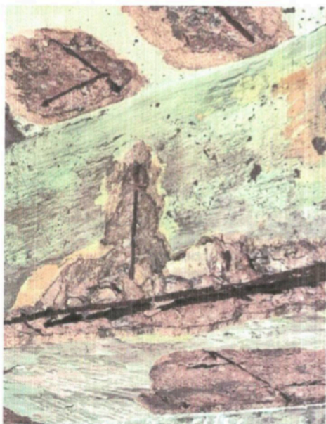
Figura 12: Corrosão severa em trecho do fundo da arquibancada
