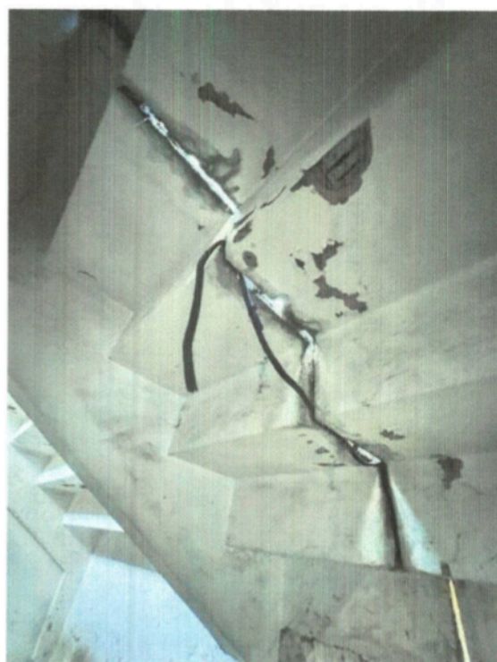
Figura 15: Junta de dilatação degradada e corrosão em trecho da arquibancada
