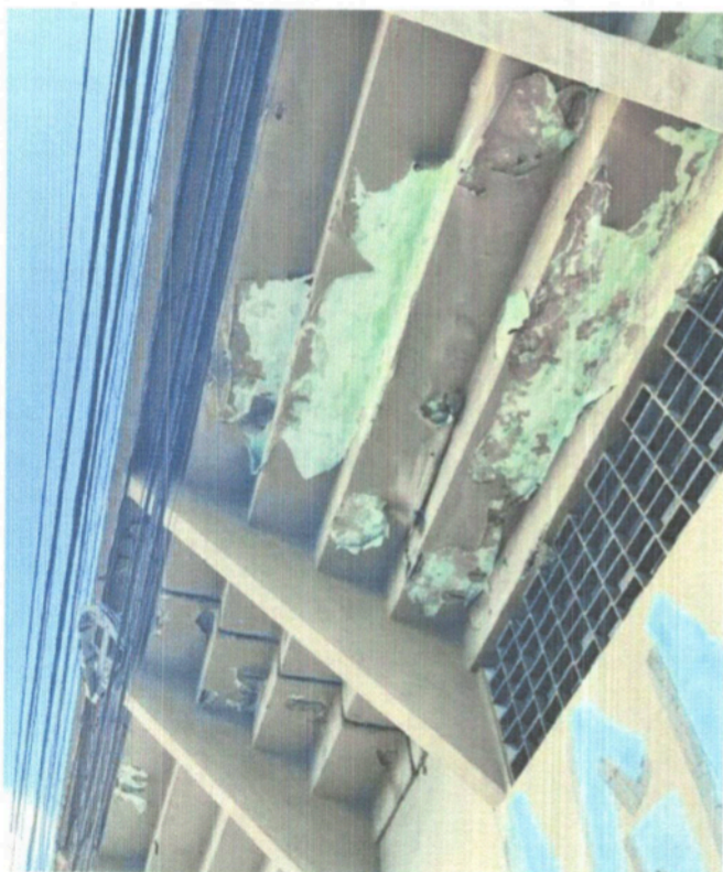
Figura 4: Deslocamentos de revestimento em pintura
