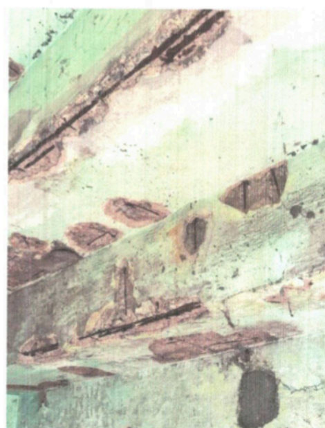
Figura 13: Corrosão severa em trecho do fundo da arquibancada em trecho com tentativa de tratamento paliativo
