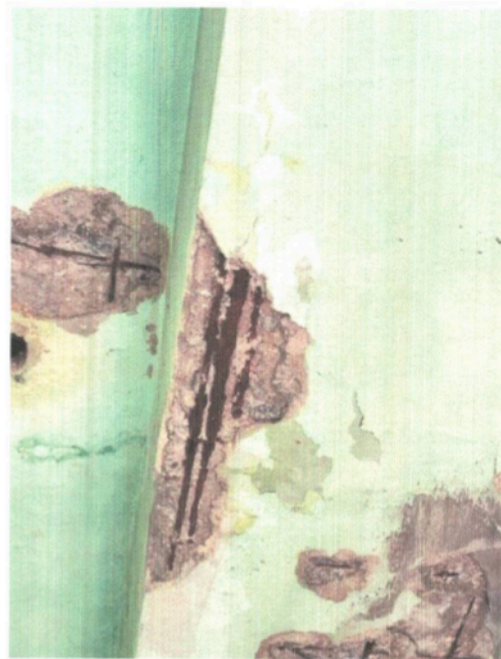
Figura 11: Corrosão severa em trecho do fundo da arquibancada
