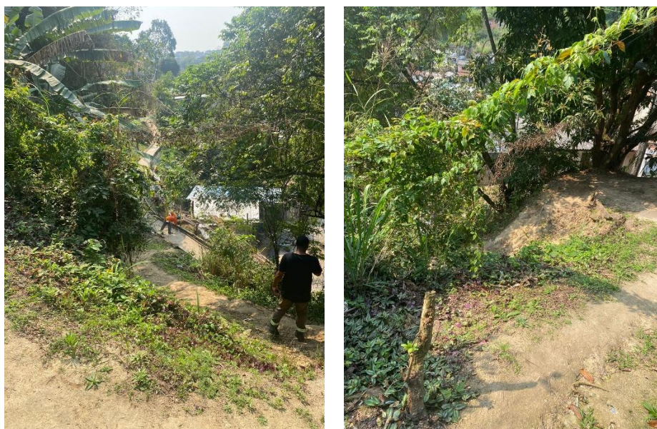
Figura 3 - Vista de encosta com solo parcialmente exposto, sem dispositivos adequados de estabilização e drenagem, indicando vulnerabilidade a processos erosivos e instabilidade do talude, o que reforça a necessidade de execução de obras de contenção para mitigação de riscos e preservação da infraestrutura urbana.
