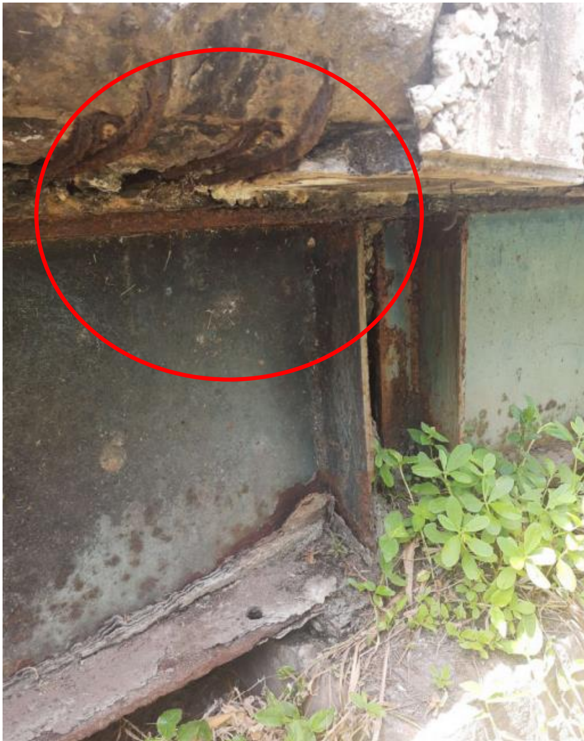
Figura 09 - As vigas de aço encontram-se em estágio avançado de corrosão, sobretudo nas regiões dos apoios.
