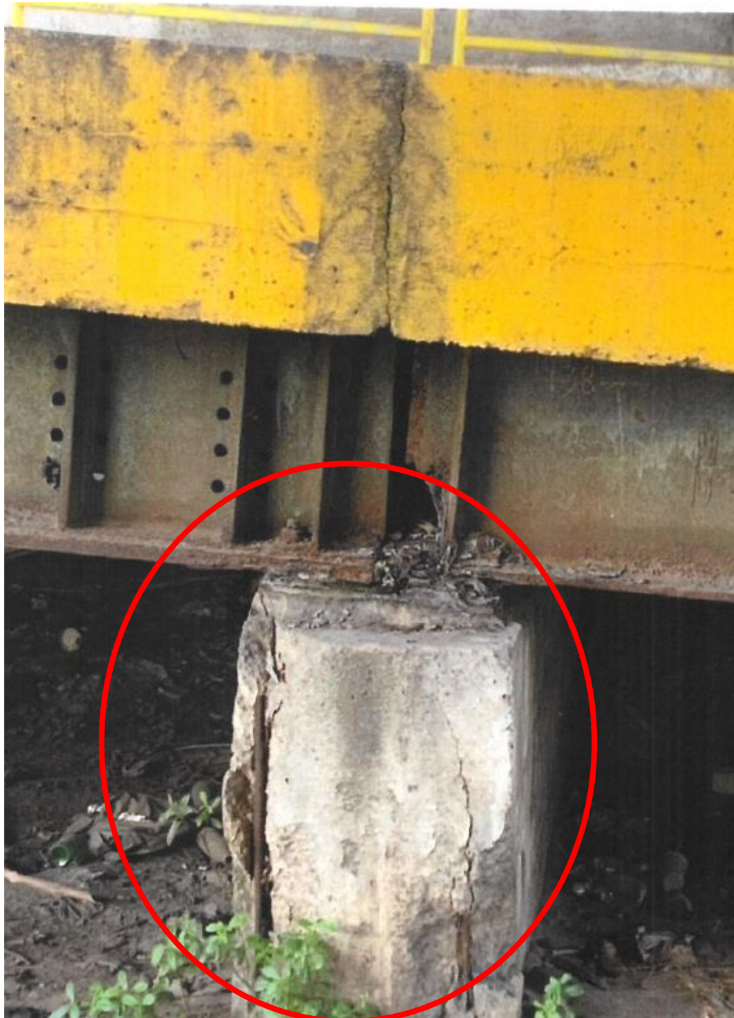
Figura 10 - Apoios de concreto armado fraturados com exposição de armaduras. Lajes de concreto sem juntas de dilatação.
