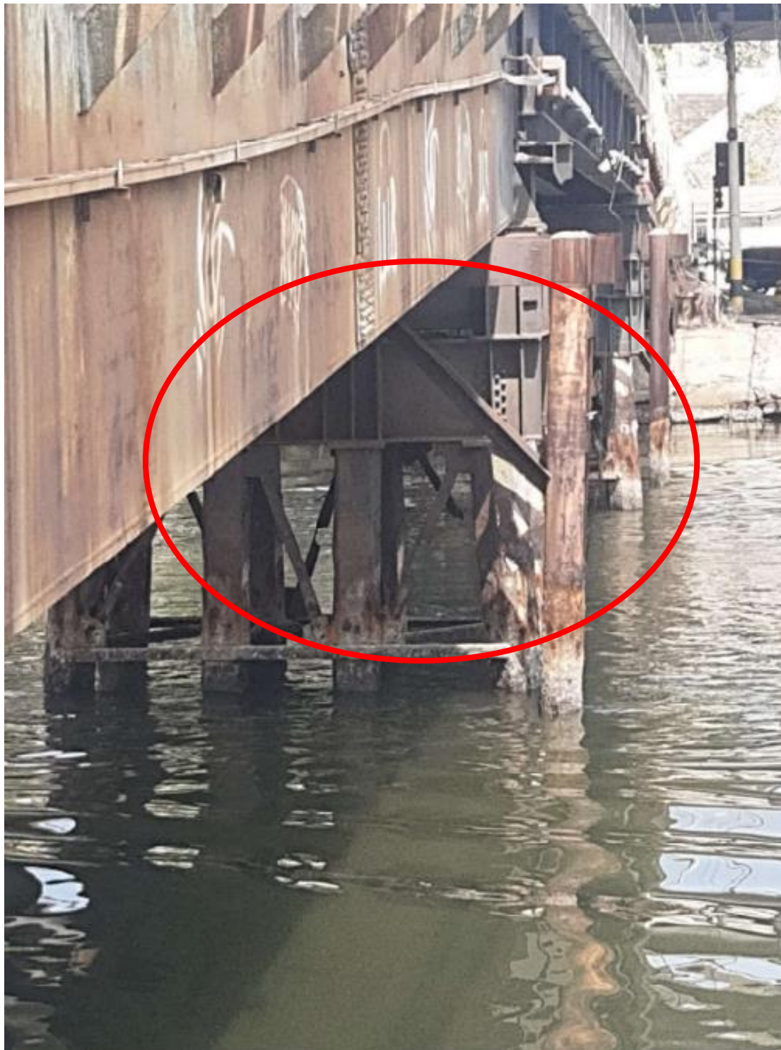
Figura 4 - As vigas de aço encontram-se em estágio avançado de corrosão, sobretudo nas regiões dos apoios
