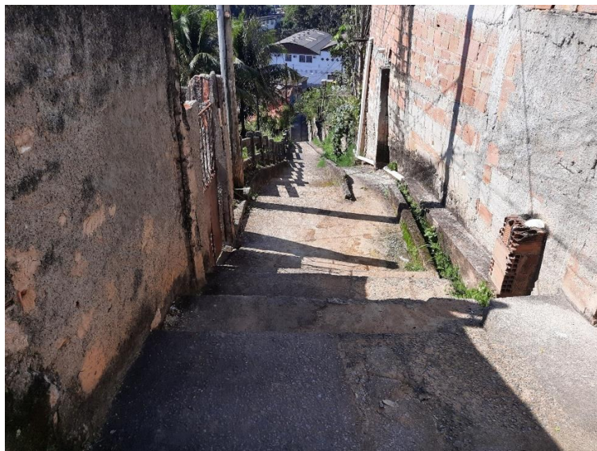
Figura 8 – Estado da escadaria
