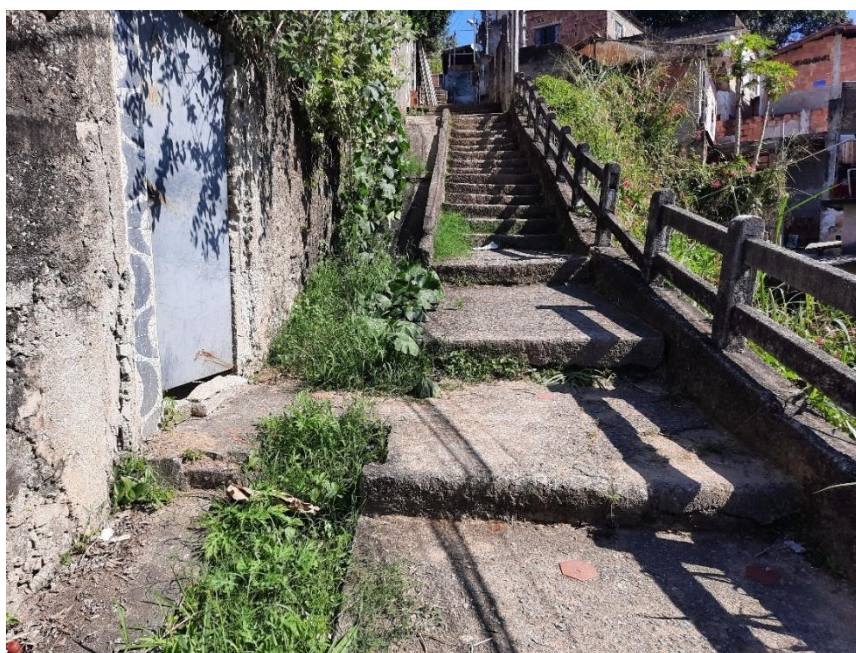
Figura 9 – Escadaria com vegetação sem serventia
