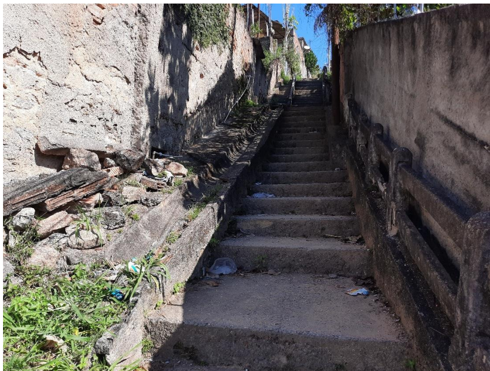
Figura 10 – Escadaria com vegetação sem serventia
