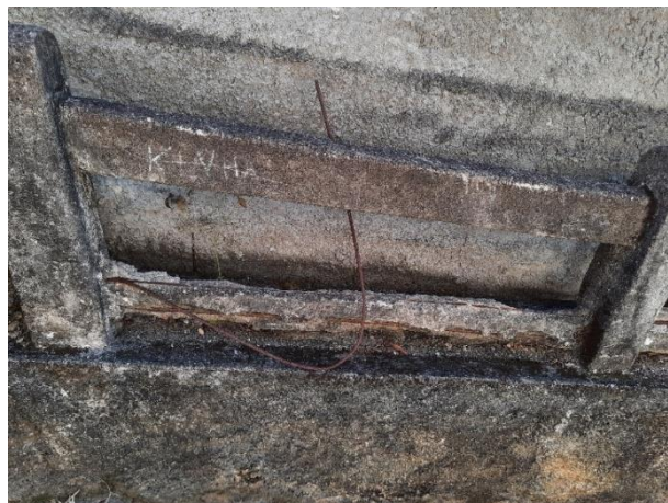
Figura 5 – Guarda-corpo com ferragem aparente
