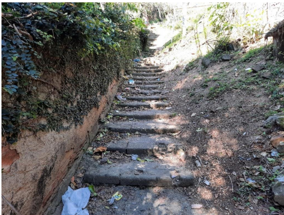
Figura 11 – Material (solo) cedendo sobre a escadaria
