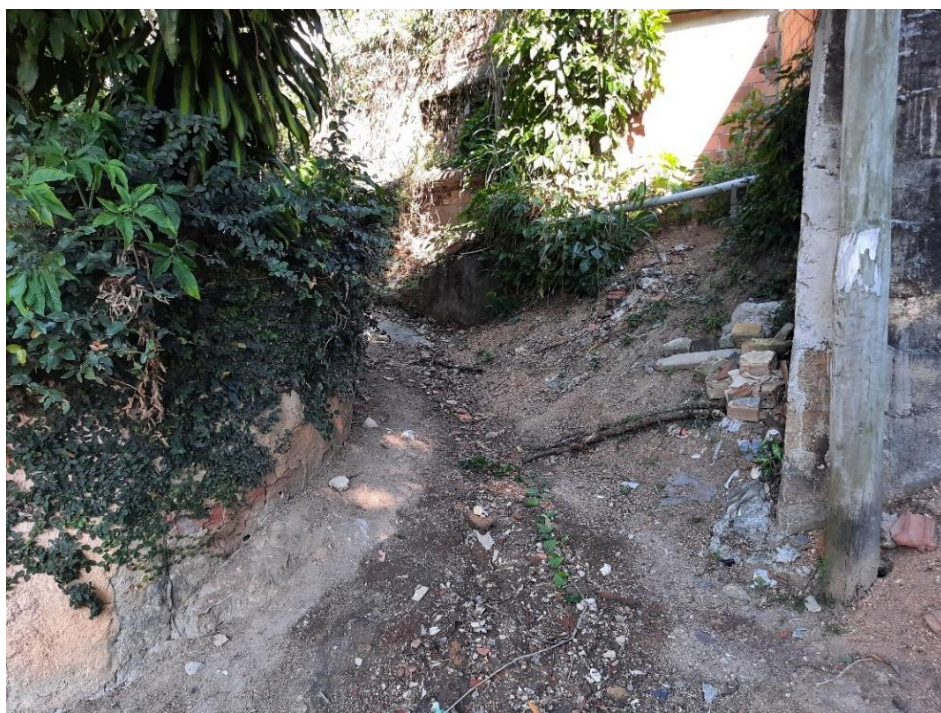
Figura 15 – Ausência de pavimentação, escoamento de águas pluviais à céu aberto
