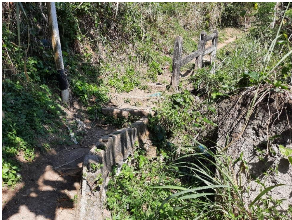
Figura 12 – Caminho estreito e com risco de queda de material
