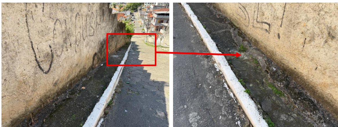
Figuras 5 e 6 - Em outro trecho do mesmo muro, também é possível observar trincas localizadas na base (pé), acompanhadas de indícios de recalque e deslocamento no alinhamento da calçada, evidenciando movimentação do solo no local. Tais condições demonstram risco potencial de instabilidade estrutural e reforçam a necessidade de intervenção para garantir a segurança dos moradores e transeuntes da via.
