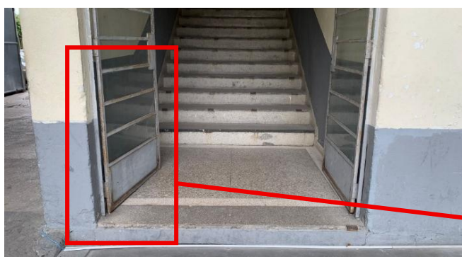
Figura 7 – Esquadria metálica oxidada
