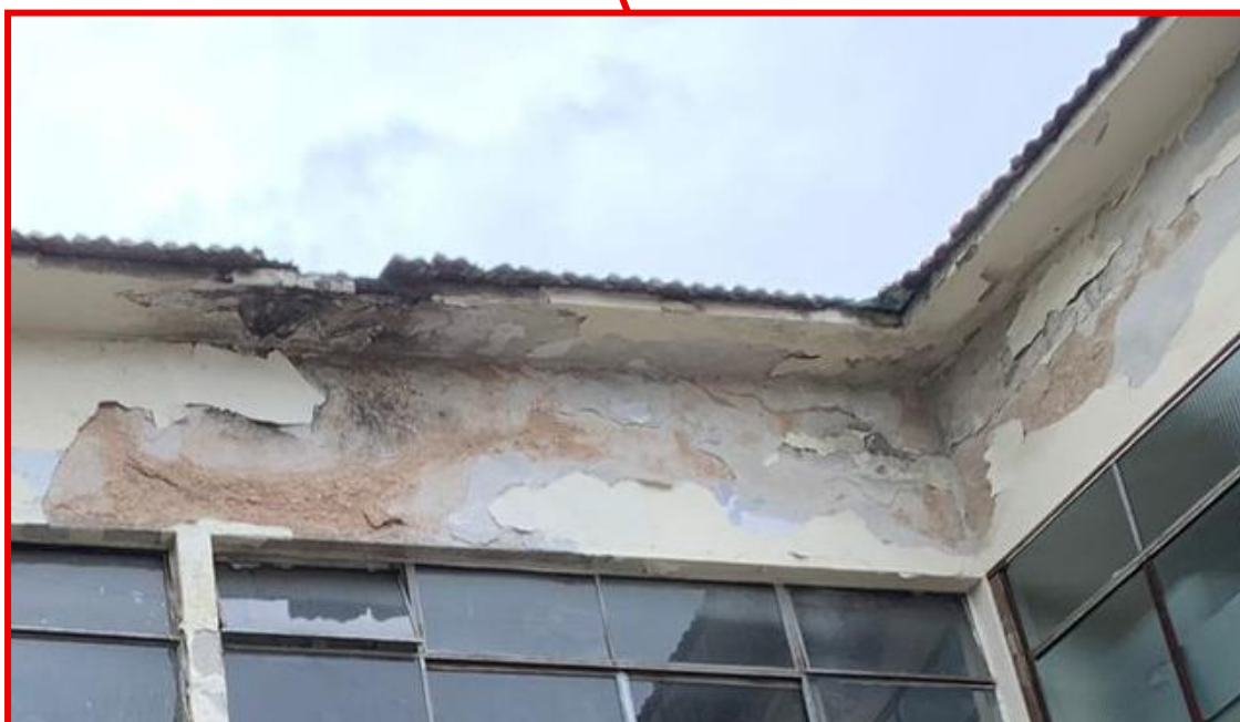
Figura 3 - Detalhe da infiltração do telhado e fachada
