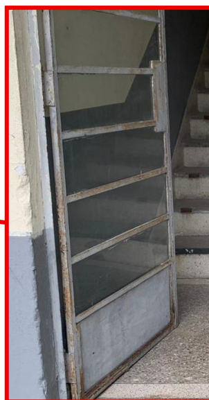
Figura 8 - Detalhe da esquadria oxidada
