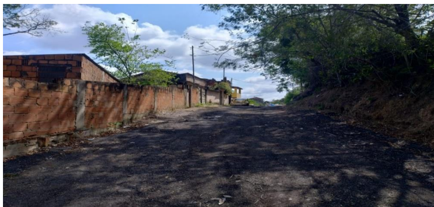
Figura 1 – Rua precisando de drenagem e pavimentação.
