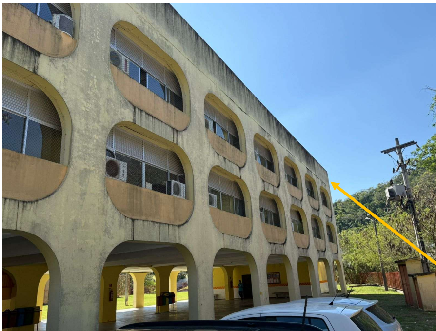
Figura 1 – Escurecimento e manchas na pintura externa
