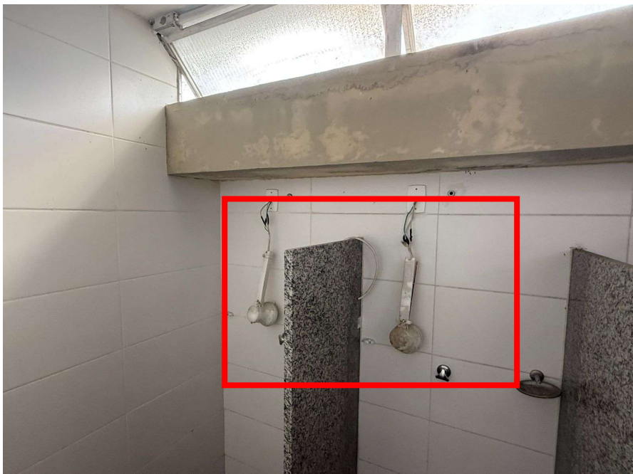
Figura 7 – Chuveiros do vestiário com danos e ausência de funcionamento
