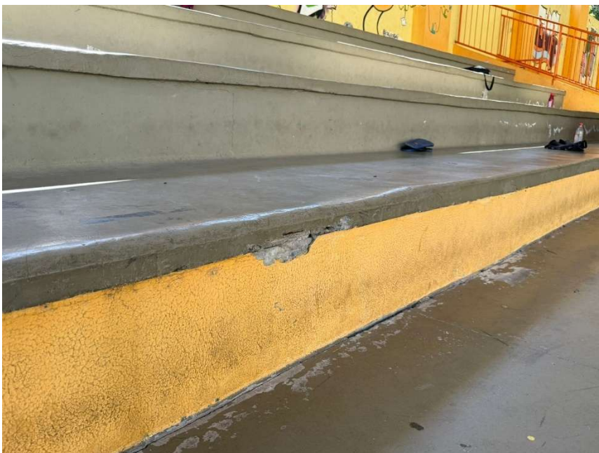
Figura 3 – Danos na arquibancada
