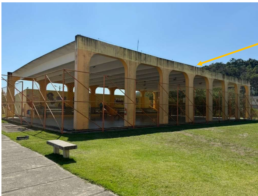
Figura 2 - Escurecimento e manchas na pintura externa
