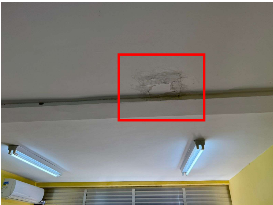
Figura 13 – Teto com sinais de infiltração
