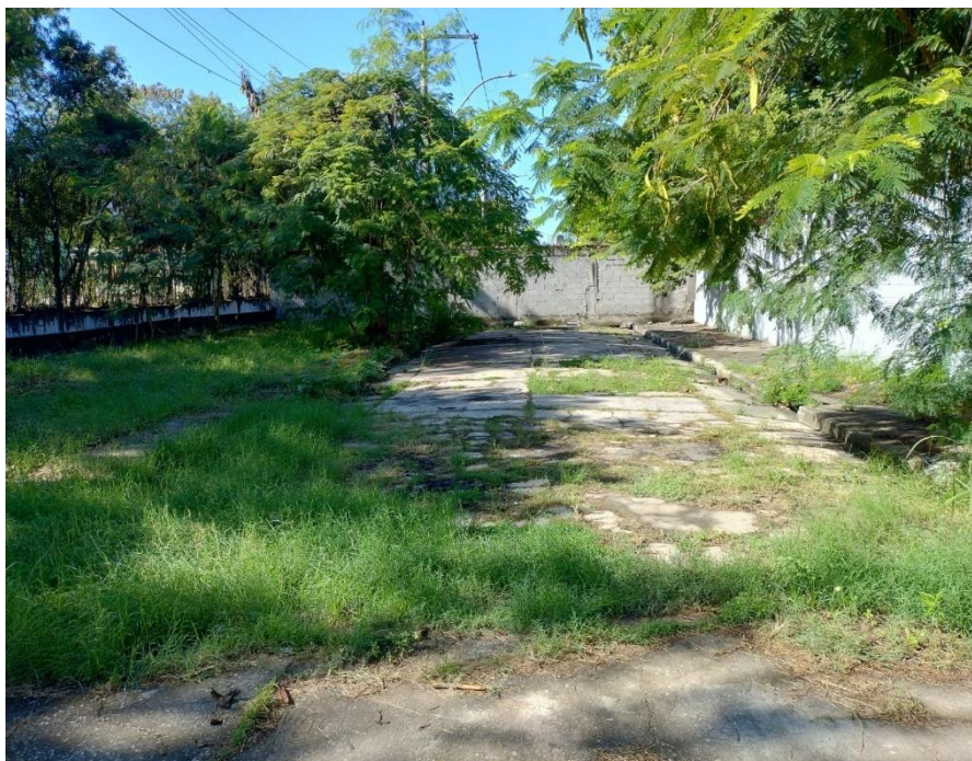
Figura 4 - Drenagem, Pavimentação e Infraestrutura precária
