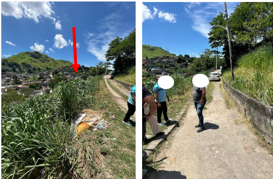
Figuras 1 e 2 – Trecho em risco de deslizamento, podendo afetar a estabilidade da via.
