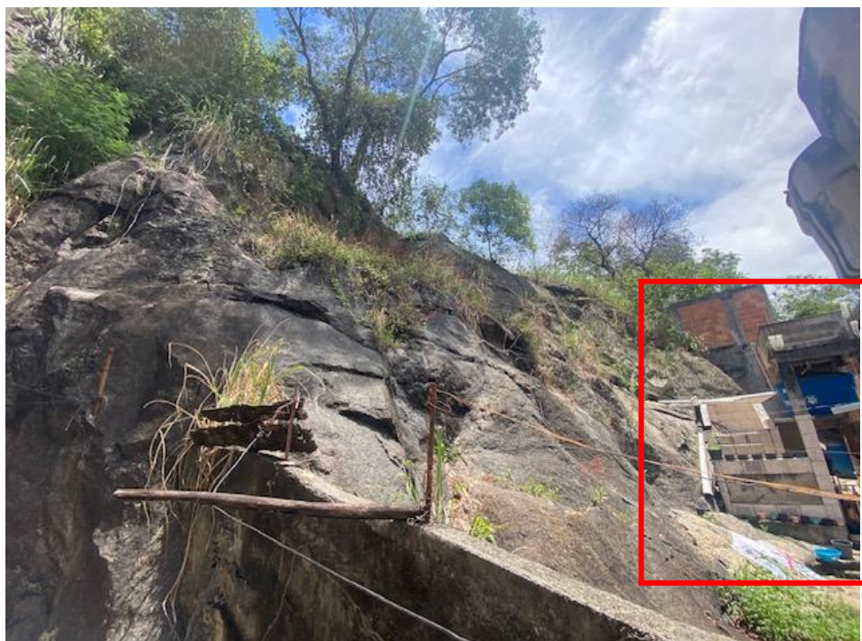
Figura 5 - A área apresenta risco para os imóveis situados a jusante.
