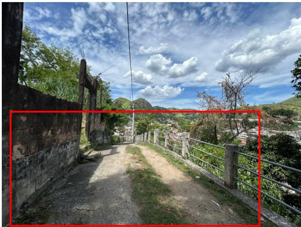
Figura 8 - A via apresenta pavimentação precária em terra, aliada à ausência de sistema de drenagem.
