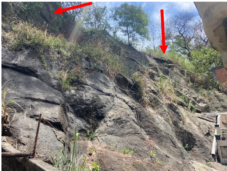
Figura 4 - Foram observados pontos de soltura de rocha no local, indicando instabilidade.
