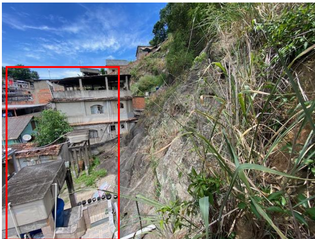
Figura 7 - Os imóveis abaixo da via estão sujeitos a danos ocasionados pela queda de material.
