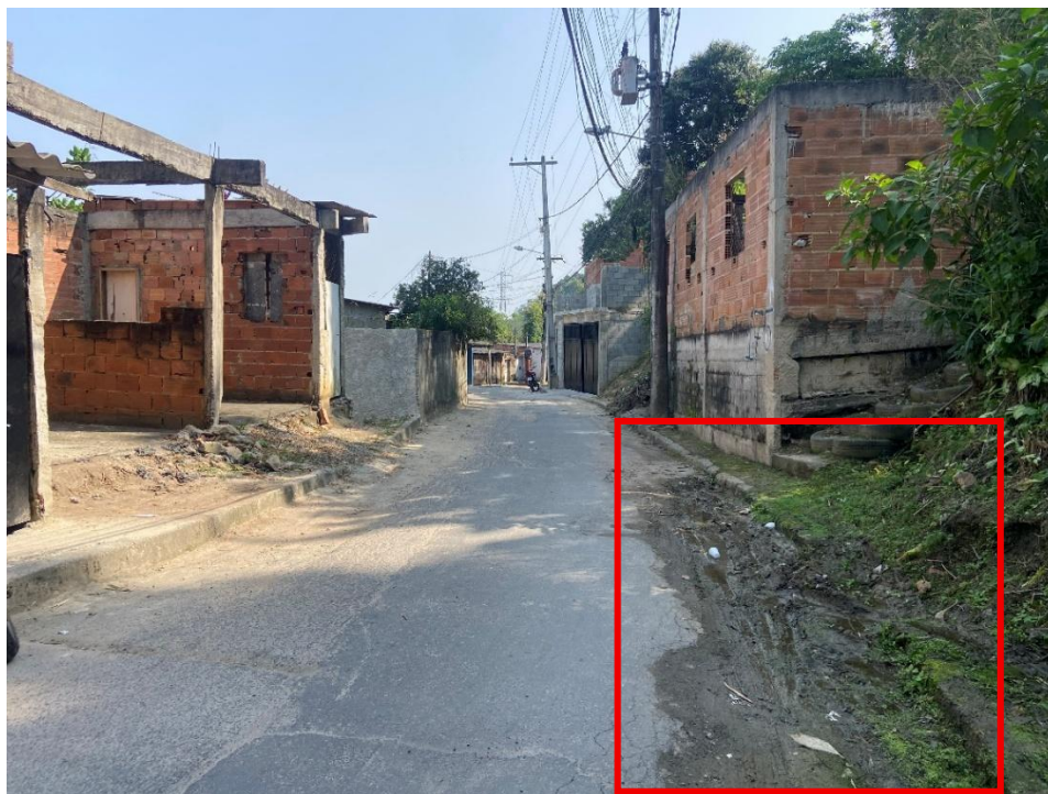
Figura 5 – Via necessitando de reparos na pavimentação e drenagem.
