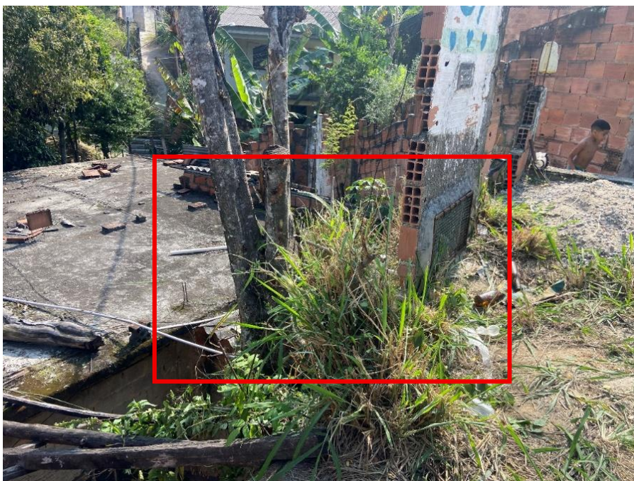
Figura 1 – Trecho que oferece risco a casa a jusante.
