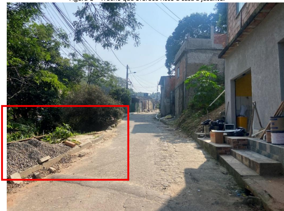
Figura 2 – Trecho que necessita de intervenção.
