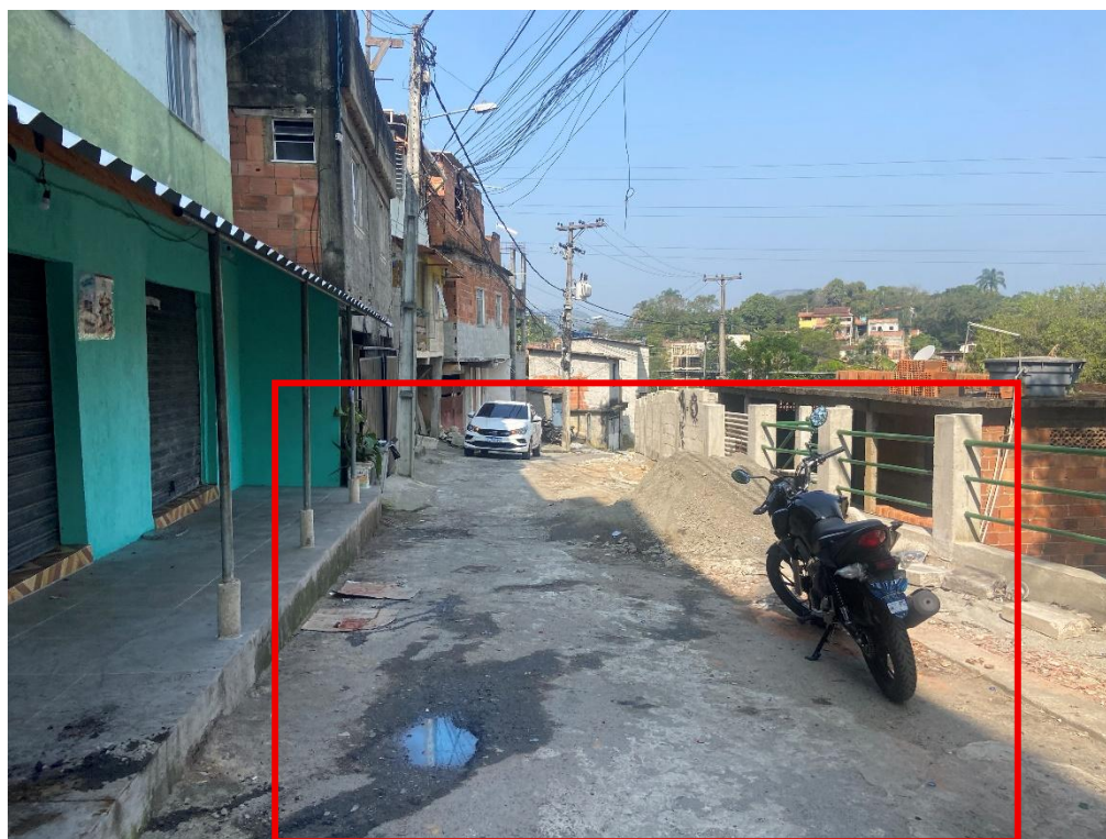
Figura 6 – Via necessitando de reparos na pavimentação e drenagem.
