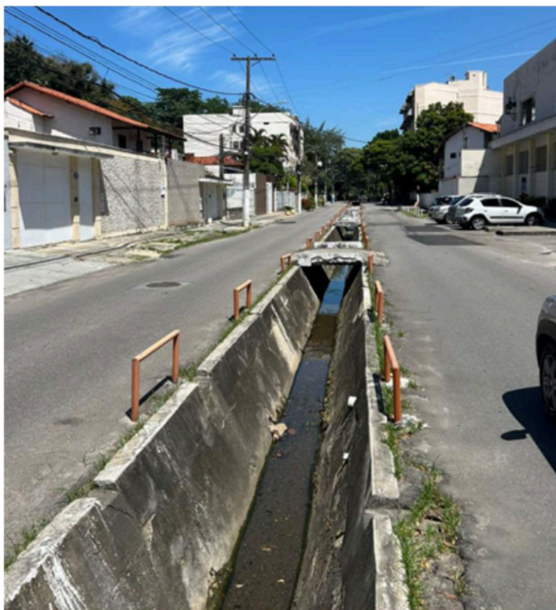
Figura 02: CANAL DE DRENAGEM DA RUA TAUBATÉ.
