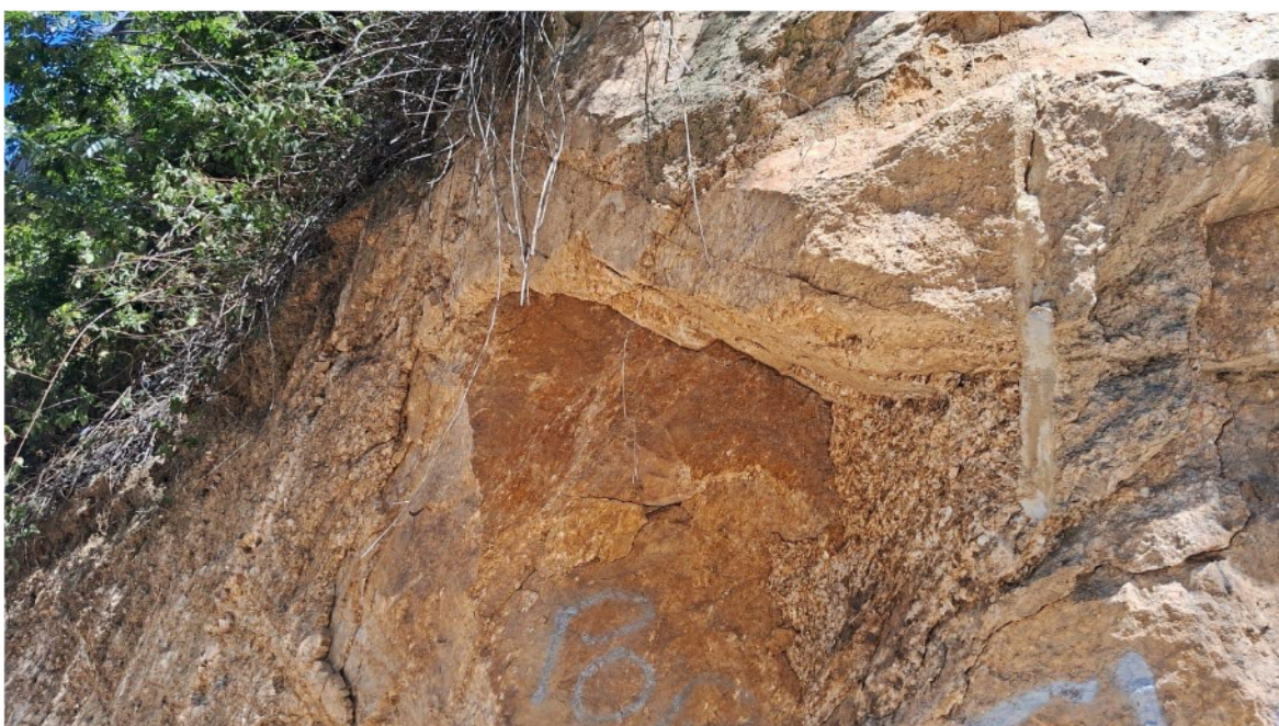
Figura 6 – Fratura aparente e risco de desprendimento.
