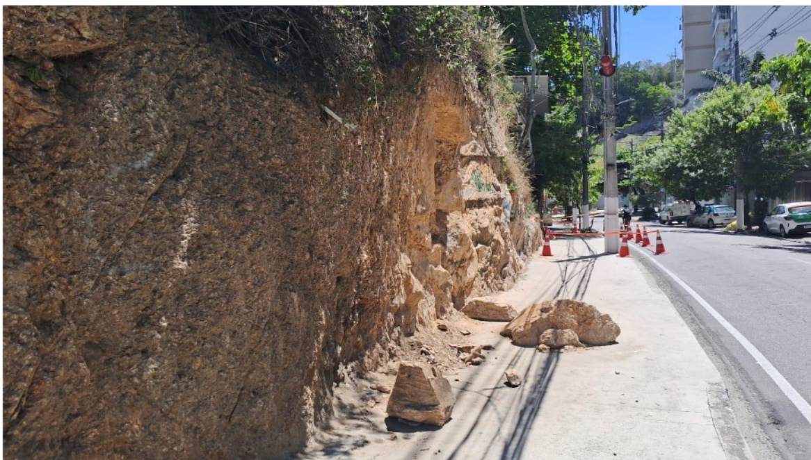
Figura 2 – Queda de blocos.
