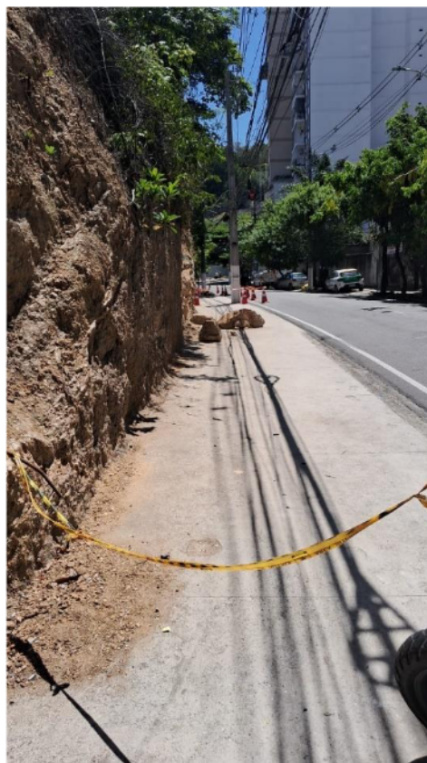
Figura 3 – Área interditada com risco de queda de blocos.
