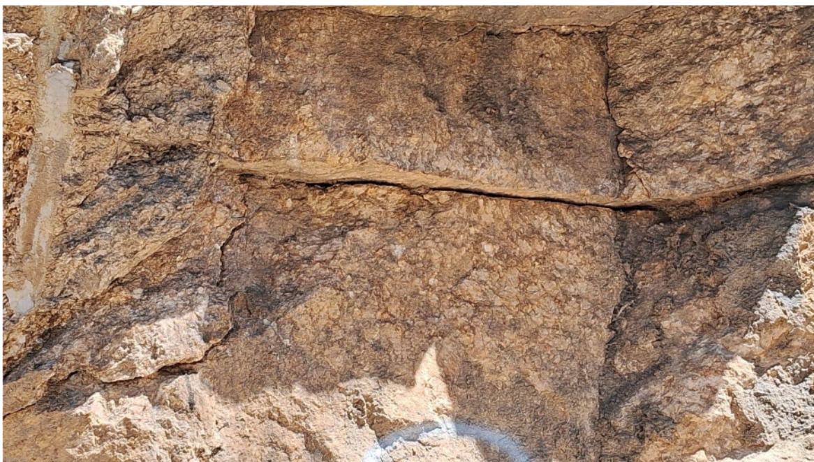
Figura 5 – Maciço rochoso com fissura aberta, indicando instabilidade e risco de desprendimento de bloco.
