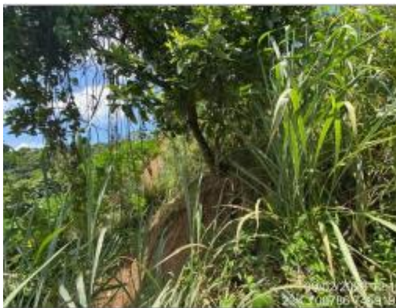
Figura 3 - Talude natural em processo avançado de instabilização, apresentando sinais claros de erosão regressiva, exposição do maciço terroso e ruptura superficial, com formação de sulcos erosivos e escarificação do terreno.
