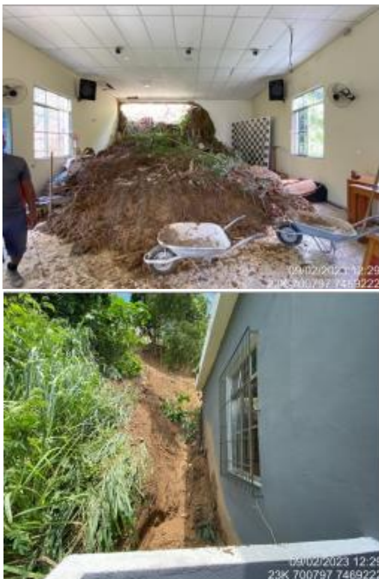
Figura 1 e 2 - Instabilização geotécnica de talude, com ruptura do maciço de solo e consequente escoamento gravitacional do material para o interior da edificação.
