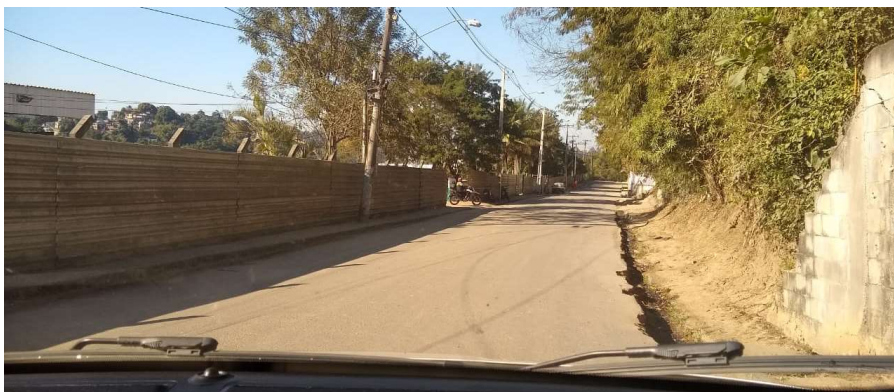
Figura 2 – Trecho viário com pavimento desgastado
