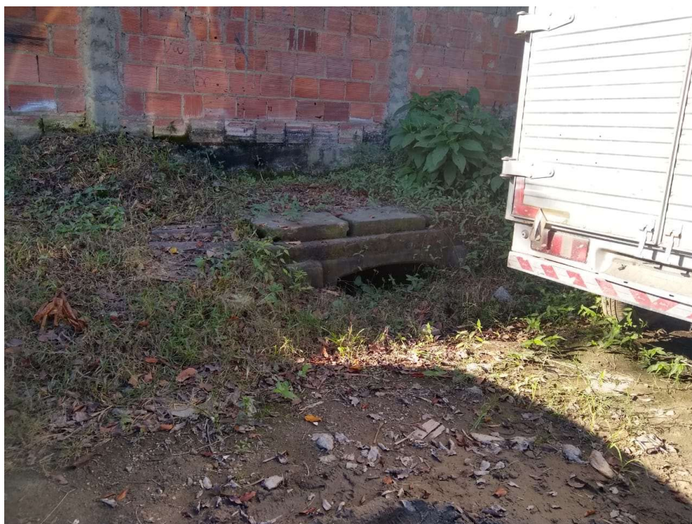
Figura 8 - Ausência de meio-fio e sarjeta, dificultando o escoamento de água
