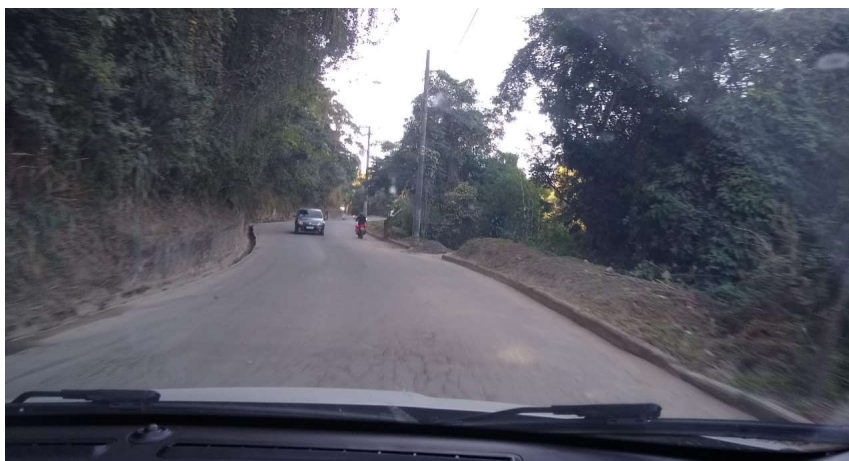
Figura 1 – Trecho em curva com pavimento desgastado
