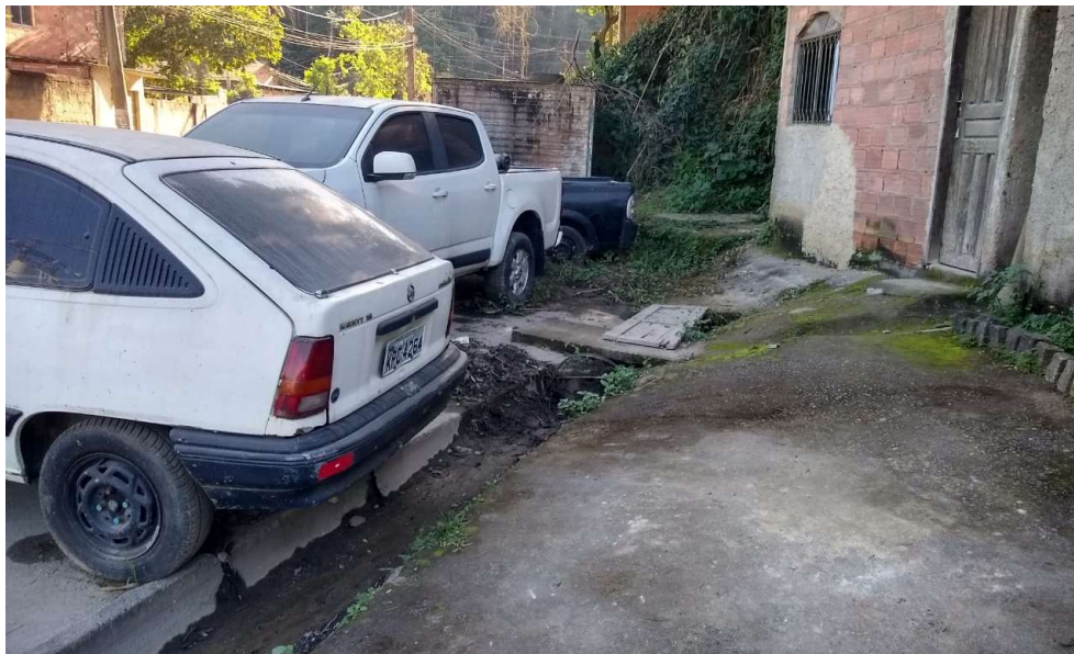
Figura 4 - Via com desgaste acentuado e falha no escoamento
