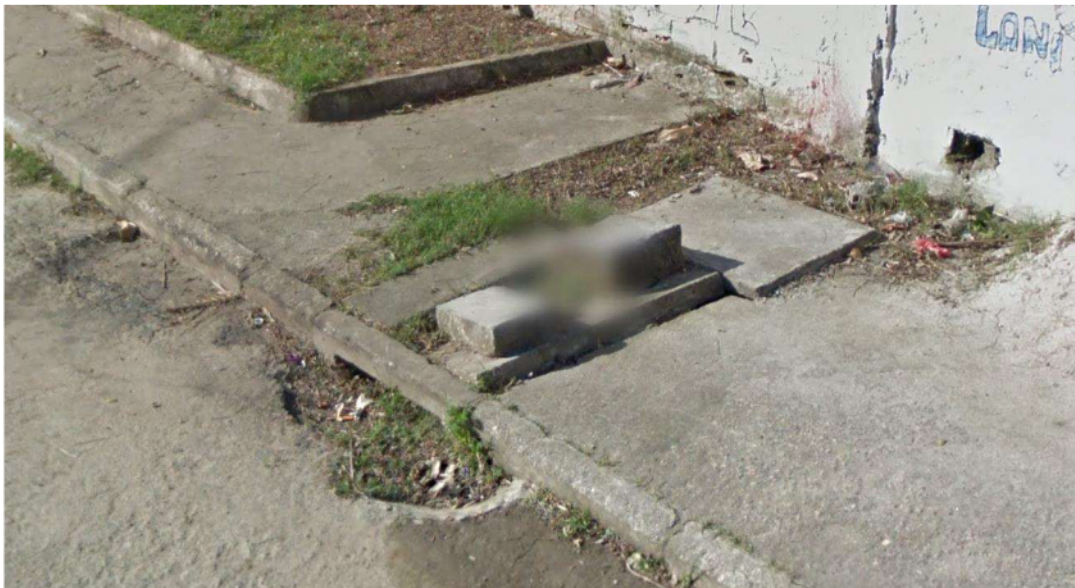
Figura 1 – Boca de lobo assoreada.
